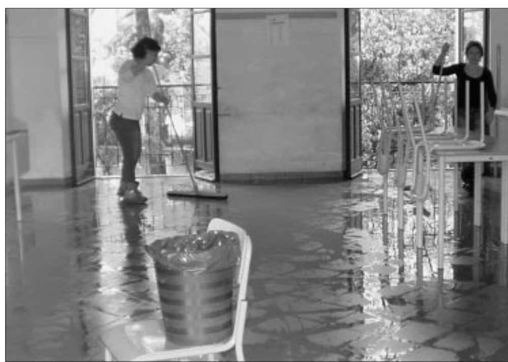
La scuola media "A. Campi" di via Gioconda, a Cremona, è stata allagata la mattina di martedì scorso a causa della rottura della saracinesca di un idrante dell'impianto antincendio sistemato al piano primo. La conseguente fuoriuscita d'acqua ha reso necessaria la chiusura della scuola per tutta la giornata.
